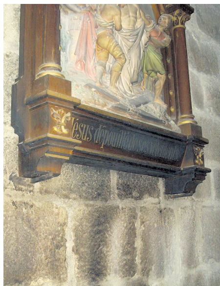
> Traces de l'incendie sur le mur de la collégiale.
